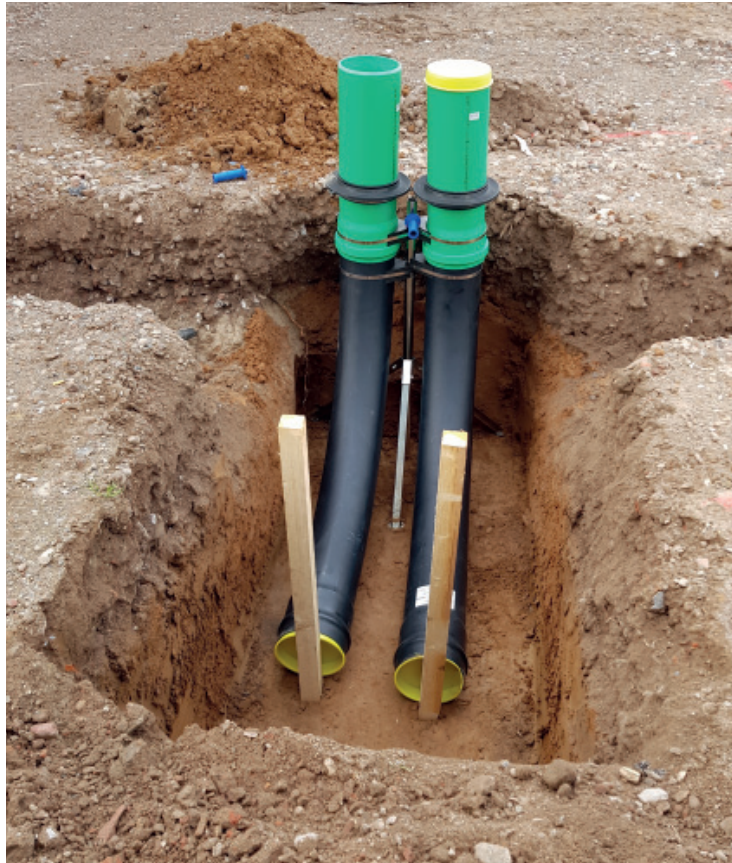
Fernwärme-Bodeneinführung 4 pipes 2-fach
